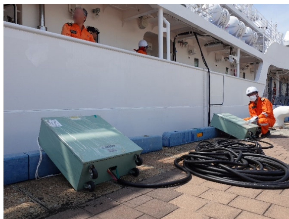
船内電源の陸上への供給ボックス
