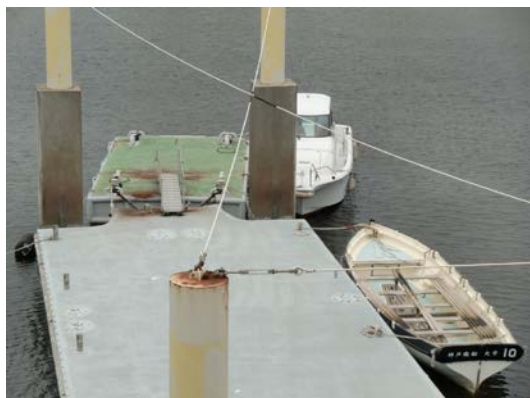
移動した小型専用栈橋（右に傾いている）
